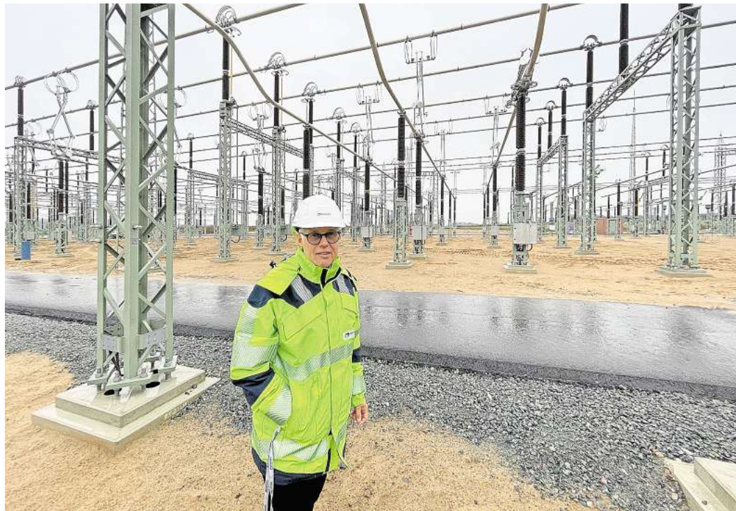
Jürgen Eichhorn (59), Projektleiter von Tennet, steht im Schaltfeld Ulzburg auf dem Gelände des Umspannwerks Lübeck-West in Stockelsdorf.
