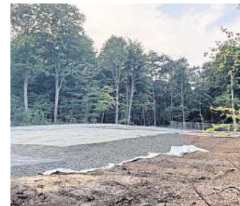
Die Ostküstenleitung geht auch durch den Meierkamp und Riesebusch in Ratekau und Bad Schwartau. In Kürze werden dort die Masten aufgestellt. Fotos: Sebastian Prey
